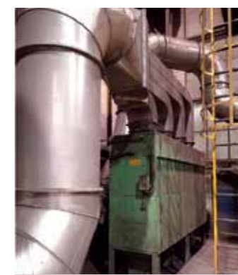
Odsávacie zariadenie - pred čistením
